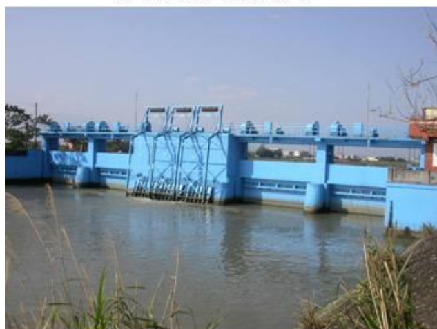
宜蘭河的防潮閘門
