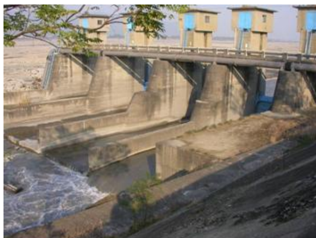
雲林林內鄉濁水溪引水閘門
