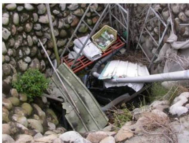
高灘地抽水井
