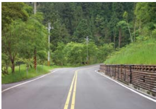
▲宜專一線10K周邊地滑潛勢與路基整治工程改善後情形
