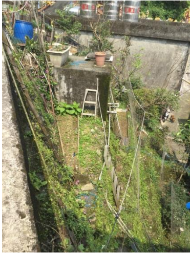
2278 地號之內現況_建地 駁坎
