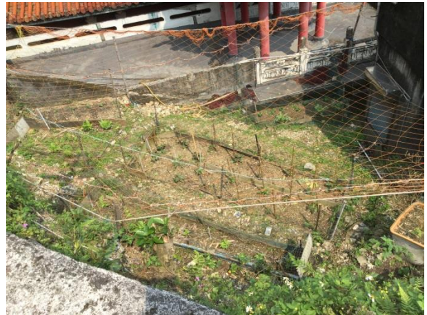
2278 地號之內現況_建地 駁坎
