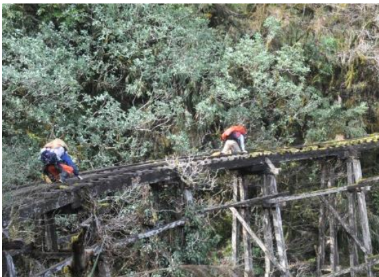
腐朽的嵐山地鐵
