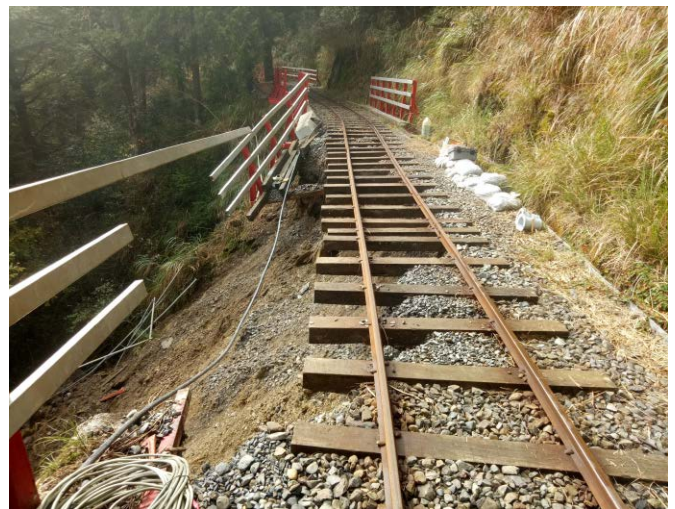
▲ 太平山蹦蹦車里程 1.1 公里處下邊坡崩塌
