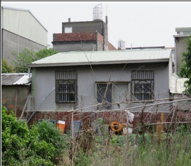
D 建物現場相片：
