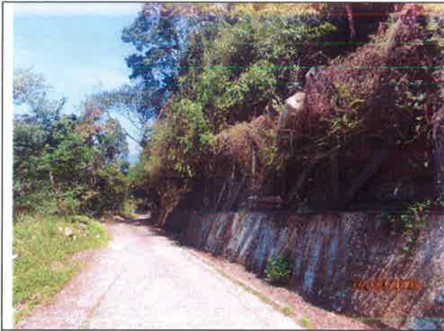
烏石坑林道巡視，X：244126，Y：2686224，路面破碎截水溝蓋露出情形，防落石網遭落石壓迫損壞。
