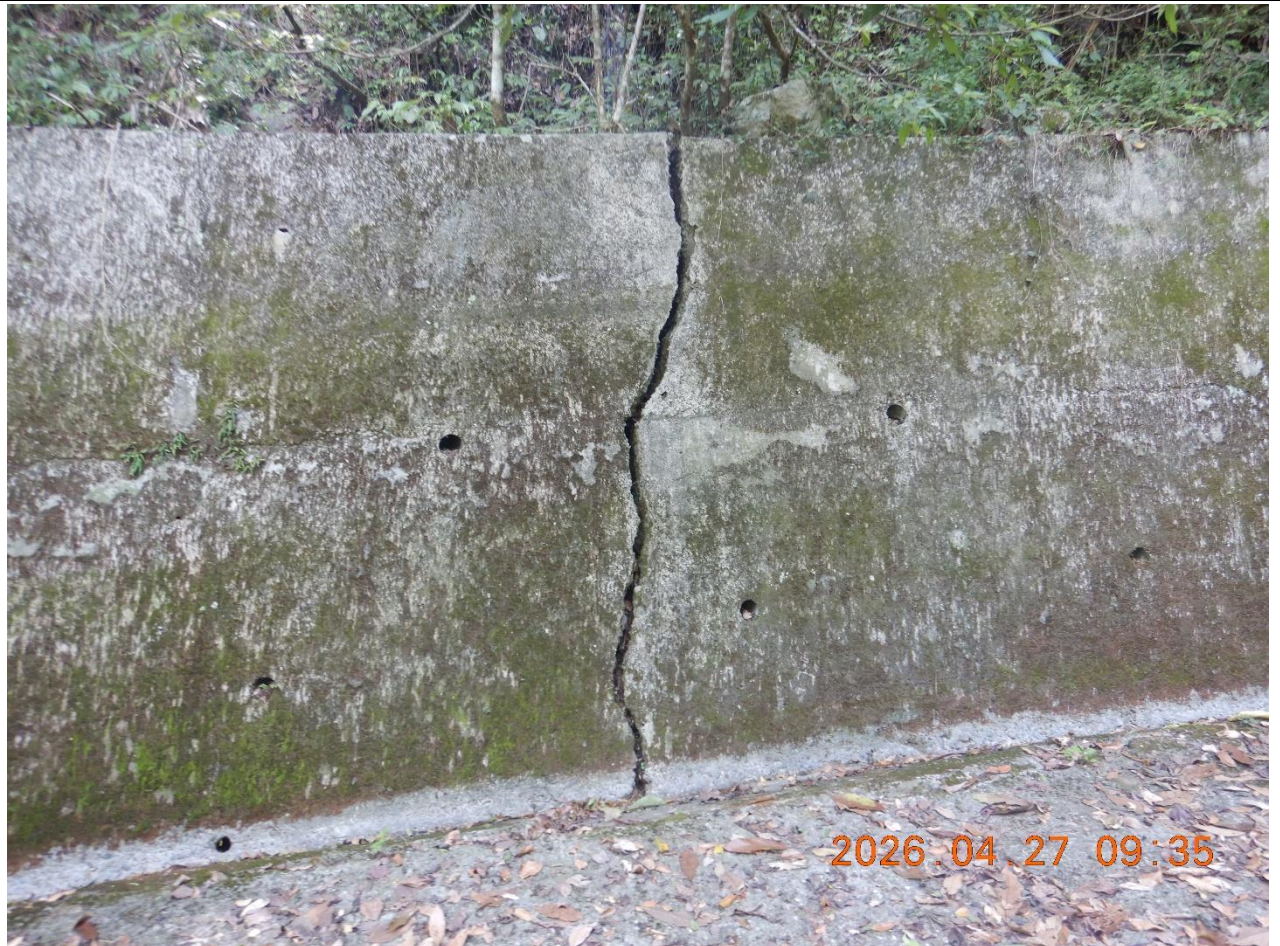
圖片2：OK+210，牆體裂縫。
