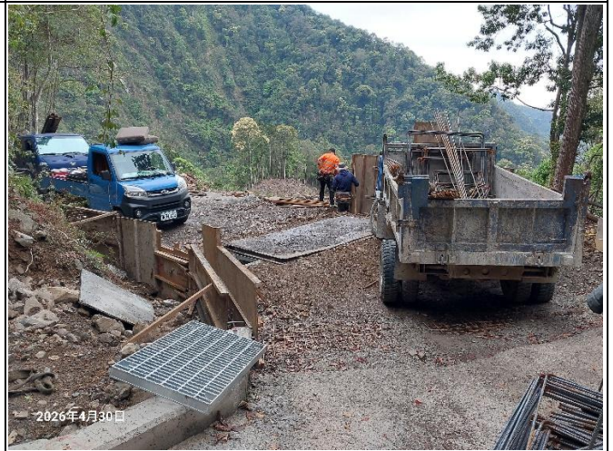
裡冷林道13K+400處，目前在進行路面灌漿，車輛無法通行。
