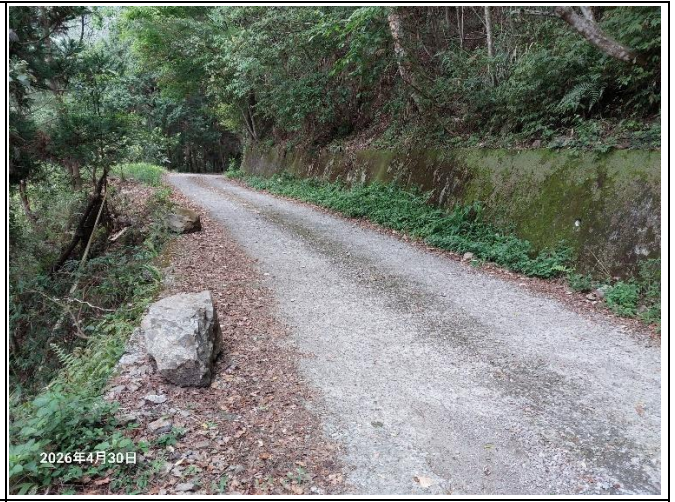
裡冷林道6K+300處，林道路面下方有掏空的情形，目前沒有太大的變動，持續觀察中。
