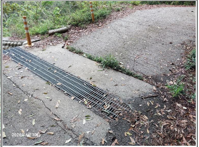
裡冷林道11K+400處，水泥路面有裂開下陷，裂痕有變寬的情形，掏空部分目前已經有墊石頭及水泥，路面落差也已用土石填補，持續觀察中。
