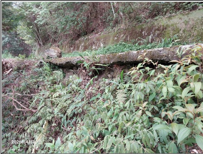
裡冷林道6K+300處，林道路面下方有掏空的情形，目前沒有太大的變動，持續觀察中。
