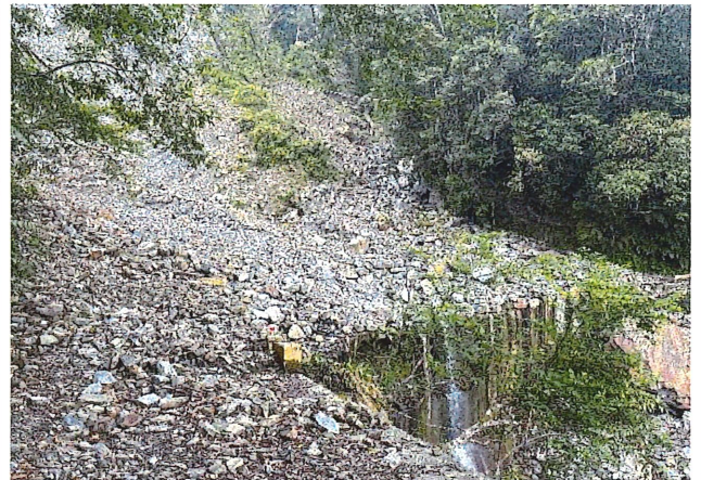
(2) 10K+200 處 座標 X:273912 Y:2572089 路面崩塌車輛無法通行
