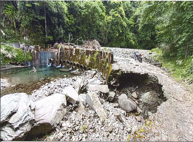
(1)林道19K+300處路基掏空情形 座標：X：278786；Y：2601165。
