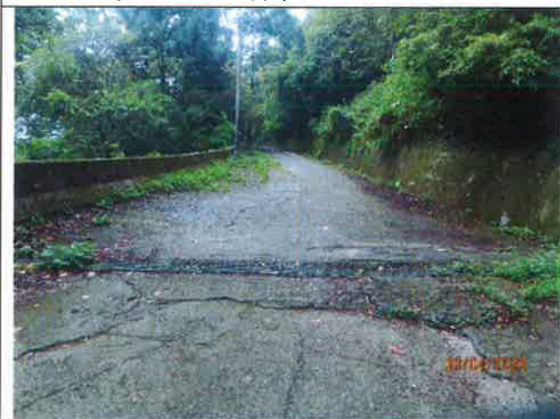
烏石坑林道巡視，X：244070，Y：2686202，截溝凹陷情形。
