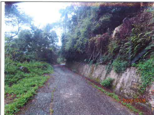
烏石坑林道巡視，X：244126，Y：2686224，路面破碎截水溝蓋露出情形，防落石網遭落石壓迫損壞。
