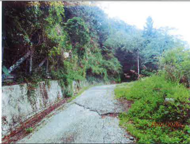
烏石坑林道巡視，X：244126，Y：2686224，路面破碎截水溝蓋露出情形，防落石網遭落石壓迫損壞。
