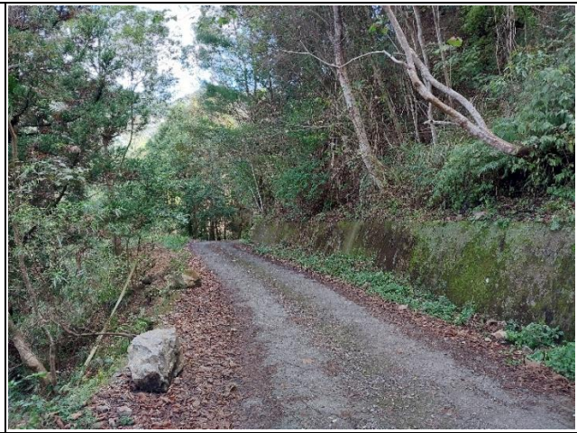
裡冷林道6K+300處，林道路面下方有掏空的情形，目前沒有太大的變動，持續觀察中。
