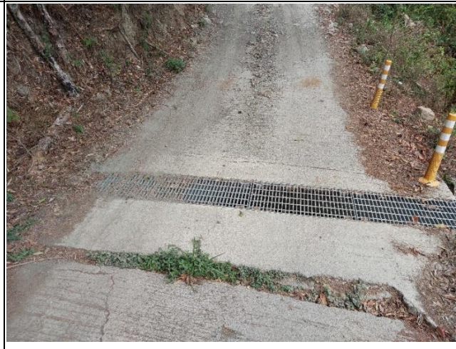
裡冷林道11K+400處，水泥路面有裂開下陷，裂痕有變寬的情形，掏空部分目前已經有墊石頭及水泥，路面落差也已用土石填補，持續觀察中。
