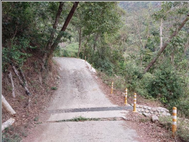
裡冷林道11K+400處，水泥路面有裂開下陷，裂痕有變寬的情形，掏空部分目前已經有墊石頭及水泥，路面落差也已用土石填補，持續觀察中。
