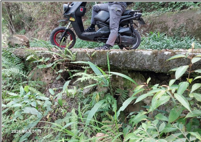
裡冷林道6K+300處，林道路面下方有掏空的情形，目前沒有太大的變動，持續觀察中。
