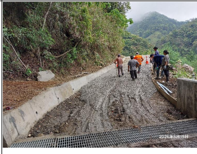
裡冷林道13K+400處，目前在進行路面灌漿，車輛無法通行。
