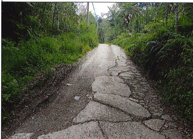
(1)林道9K+200處路面龜裂凹凸不平落差部分最大達17公分，座標：X:280030；Y:2599186。
