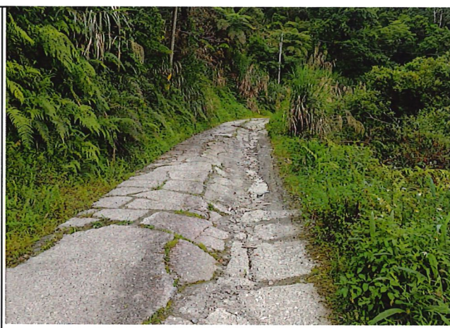
(2)林道9K+600處路面龜裂凹凸不平落差部分最大達23公分，座標：X:279828；Y:2599132。
