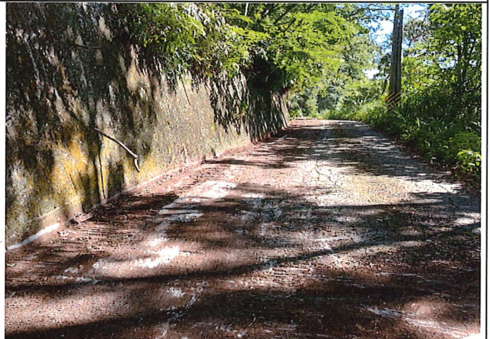
(4)4k+450處 座標X:277483 Y:2574044 路面淤積汛期前排水施工機具及人員於現場施工後
