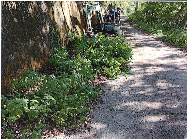
(3)4k+450處 座標X:277483 Y:2574044 路面淤積汛期前排水施工機具及人員於現場施工中
