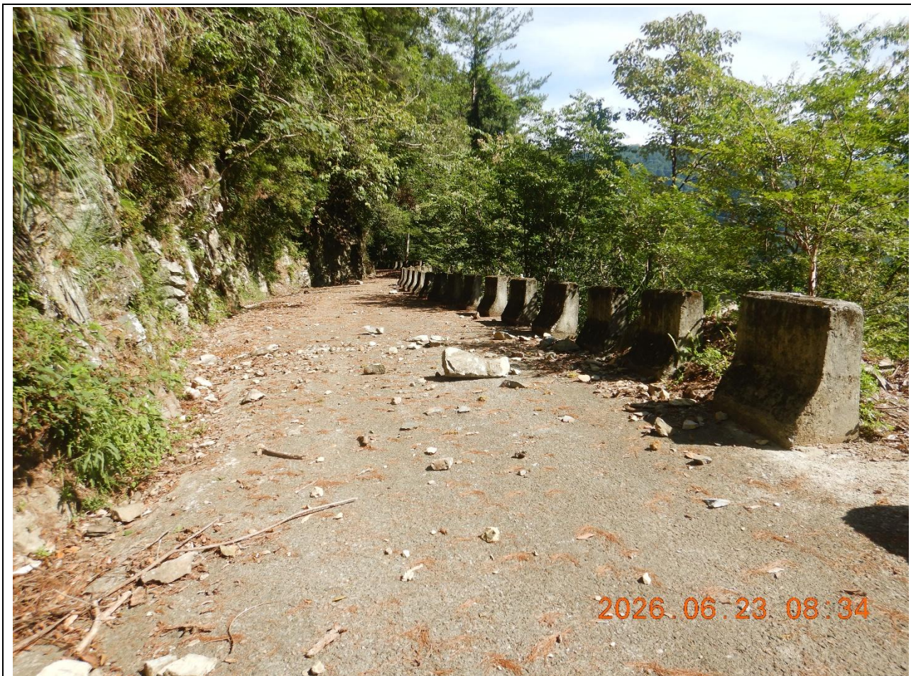
圖片5：0K+530，路面落石，護欄無異狀。
