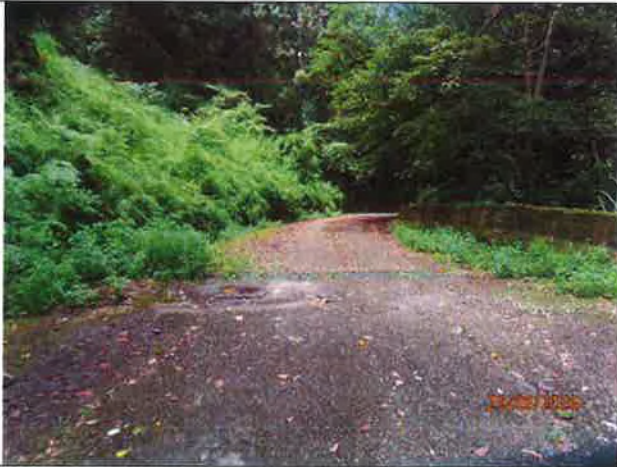
烏石坑林道巡視，X：244070，Y：2686202，截溝凹陷情形。
