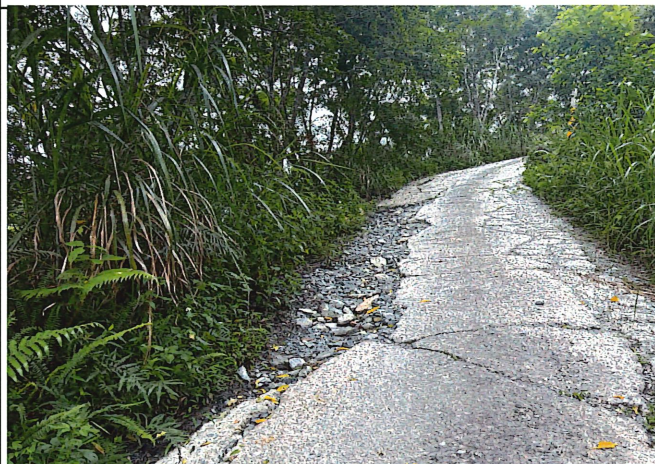
(4)林道6k+200 處 水泥路面破碎 座標：X:281066；Y:2599738。
