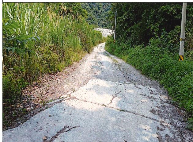
(5)林道9k+400 處 水泥路面破碎 座標：X:279922；Y:2599139。
