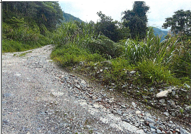
(6)林道9k+600 處 水泥路面雨水冲刷破碎 座標：X:279790；Y:2599085。
