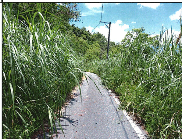
照片4：中平林道0k-8K 道路兩旁多處 芒草過長，建議僱工剪除。
