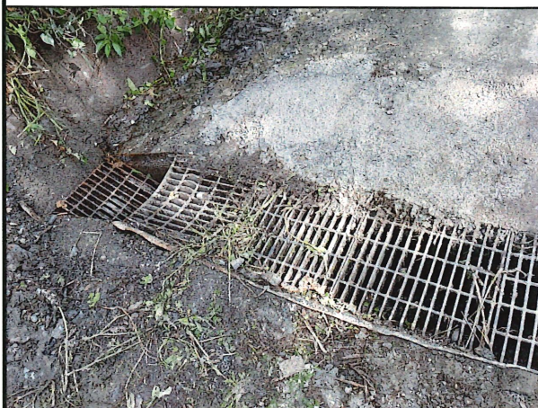
照片1：中平林道7k+400處座標X：279713、Y：2590190。 格柵式水溝蓋凹陷變形，建議進行修繕汰換。
