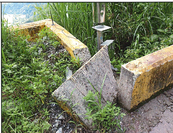
照片7：中平林道7k+300處座標X：279767、Y：259097。 水泥牆體斷裂，恐危及監測設備。
