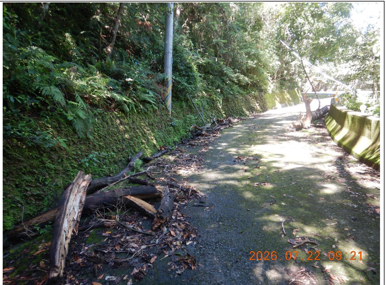
圖片3：0K+270，路面倒木，邊溝堆積，護欄無異狀。
