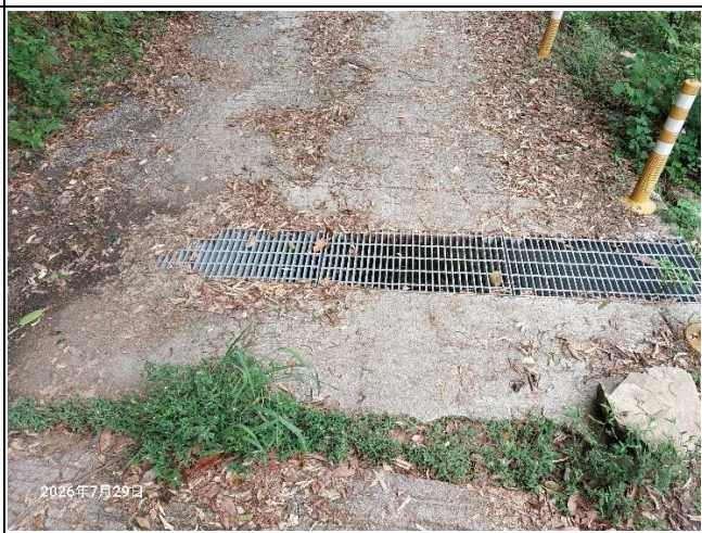
裡冷林道11K+400處，水泥路面有裂開下陷，傾斜度有緩慢增加，持續觀察中。
