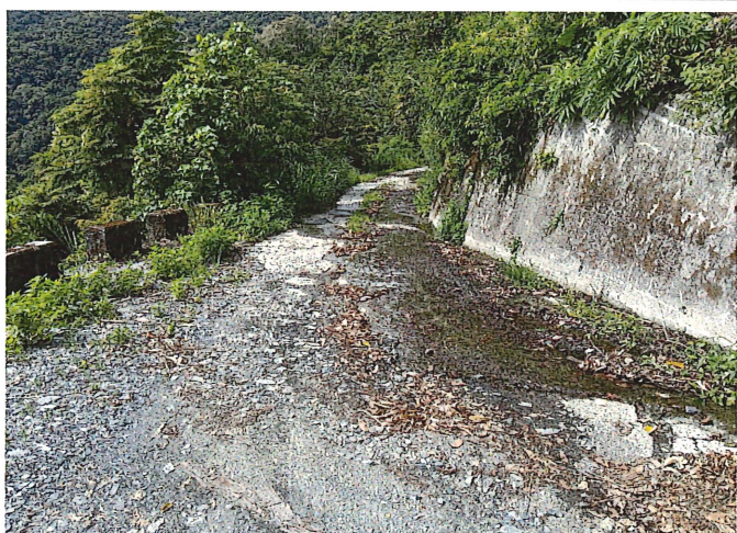
照片 5：中平林道 7K+450 X:279771、Y:2590304 道路積水路段，路面破損。
