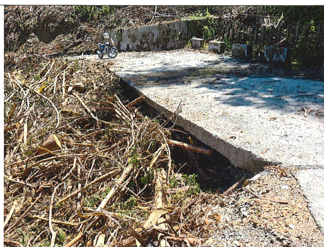
照片 2：中平林道 13K 處座標 X:278207、Y:2590160，路面地基掏空(長約 8 米)
