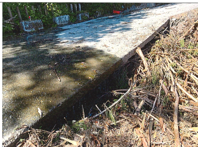
照片 1：中平林道 13K 處座標 X:278207、Y:2590160，路面地基掏空(長約 8 米)
