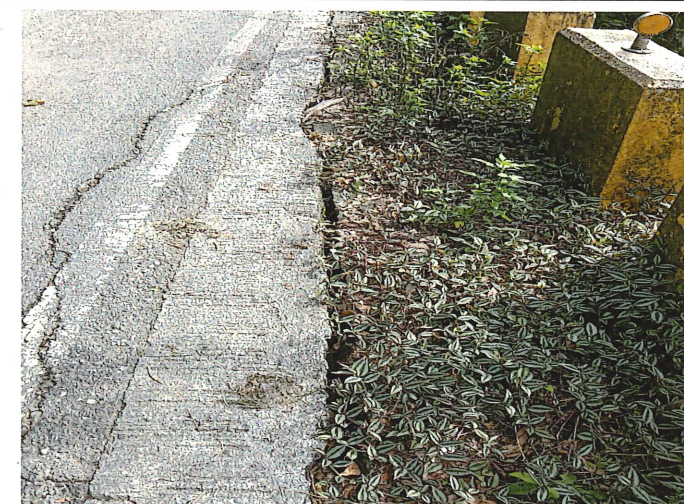
照片 3：中平林道 3K+400 處座標 X:281615、Y:2589901。路面與邊坡中有縫隙(長約 10 米)。
