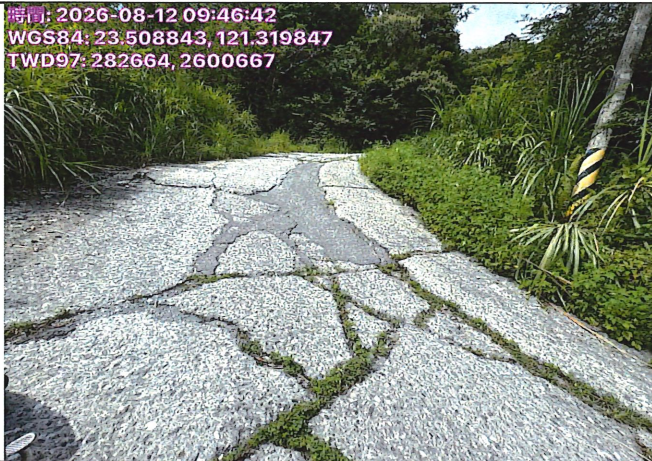
(2)林道1k+200處 路面破碎 座標: X:282664; Y:2600667。
