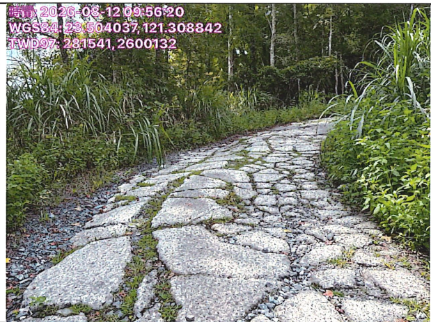
(5)林道4k+500處 路面破碎 座標: X:281541; Y:2600132。
