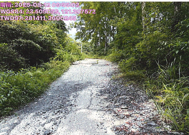
(4)林道4k+200處 路面碎石 座標: X:281411; Y:2600245。
