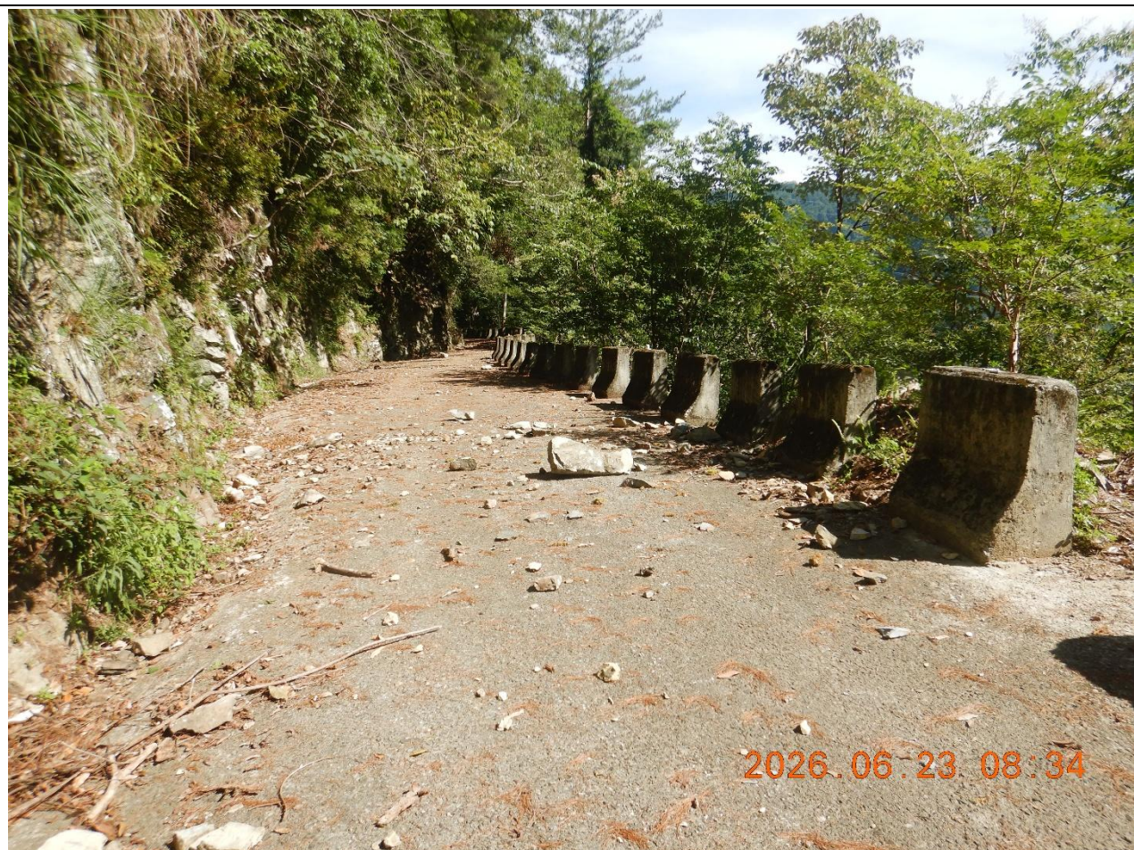
圖片5：0K+530，路面落石，護欄無異狀。
