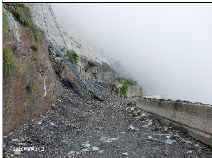
裡冷林道18.4K處，有下雨就還是會持續掉落土石，目前可通行。
