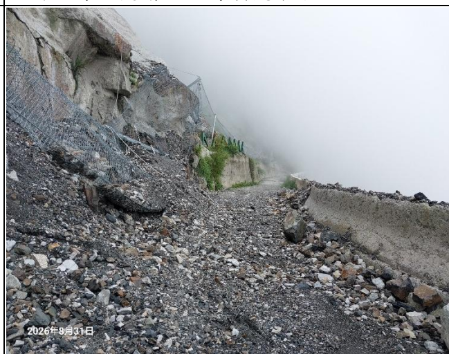
裡冷林道18.4K處，有下雨就還是會持續掉落土石，目前可通行。
