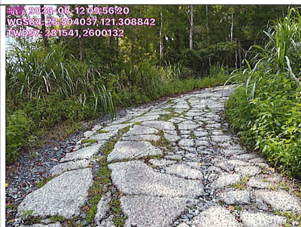
(5)林道4k+500處 路面破碎 座標: X:281541; Y:2600132。
