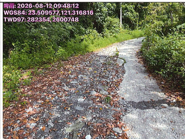
(3)林道1k+800處 路面碎石破碎 座標: X:282354; Y:2600748。
