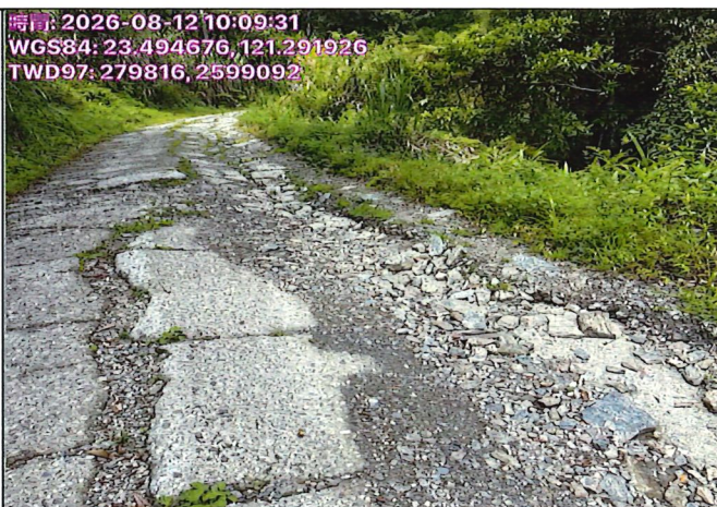
(8)林道9k+600處 水泥路面破碎右側有雨水沖刷跡象 座標: X:279816; Y:2599092。
