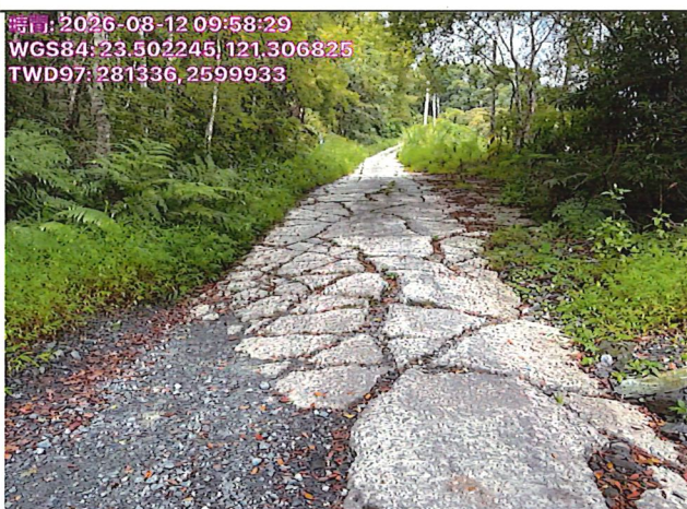
(6)林道5k+000處 水泥路面破碎隆起 座標: X:281336; Y:2599933。
