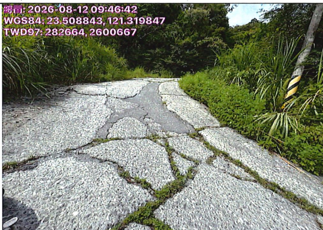
(2)林道1k+200處 路面破碎 座標: X:282664; Y:2600667。
