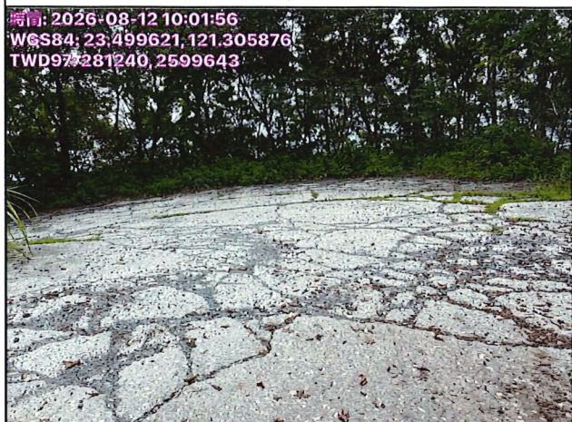
(7)林道6k+200處 路面碎石破碎 座標: X:281240; Y:2599643。
