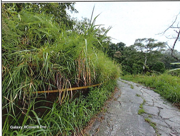
(5)6K+900處 座標X:275918 Y:2573456 擋土牆上方受土石壓力擠壓，結構體已呈現傾斜且牆體受損裂縫龜裂，若不幸倒塌將形成大量土石順勢崩塌，進而阻斷林道交通擊影響用路人之虞。(巡查員已設警示帶預警)
