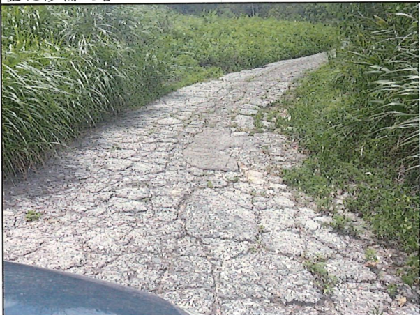
(3)1K+350處 座標X:278710 Y:2575323 林道 路面呈現混凝土劣化碎裂／破損，建議進行平整化修補改善。
