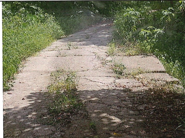
(1)8K+080處 座標X:275173 Y:2573079 林道路面呈現混凝土劣化碎裂／破損，建議進行平整化修補改善。
