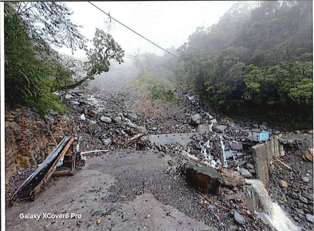
(6)本月開口契約承攬廠商進行林道改善工程，因8月24日發布豪大雨影響，該工區溪溝發生崩塌，大流量土沙沖毀林道基礎。開口契約廠商改善工程尚持續進行中，將重修臨時作業道方便人車通行林道。
