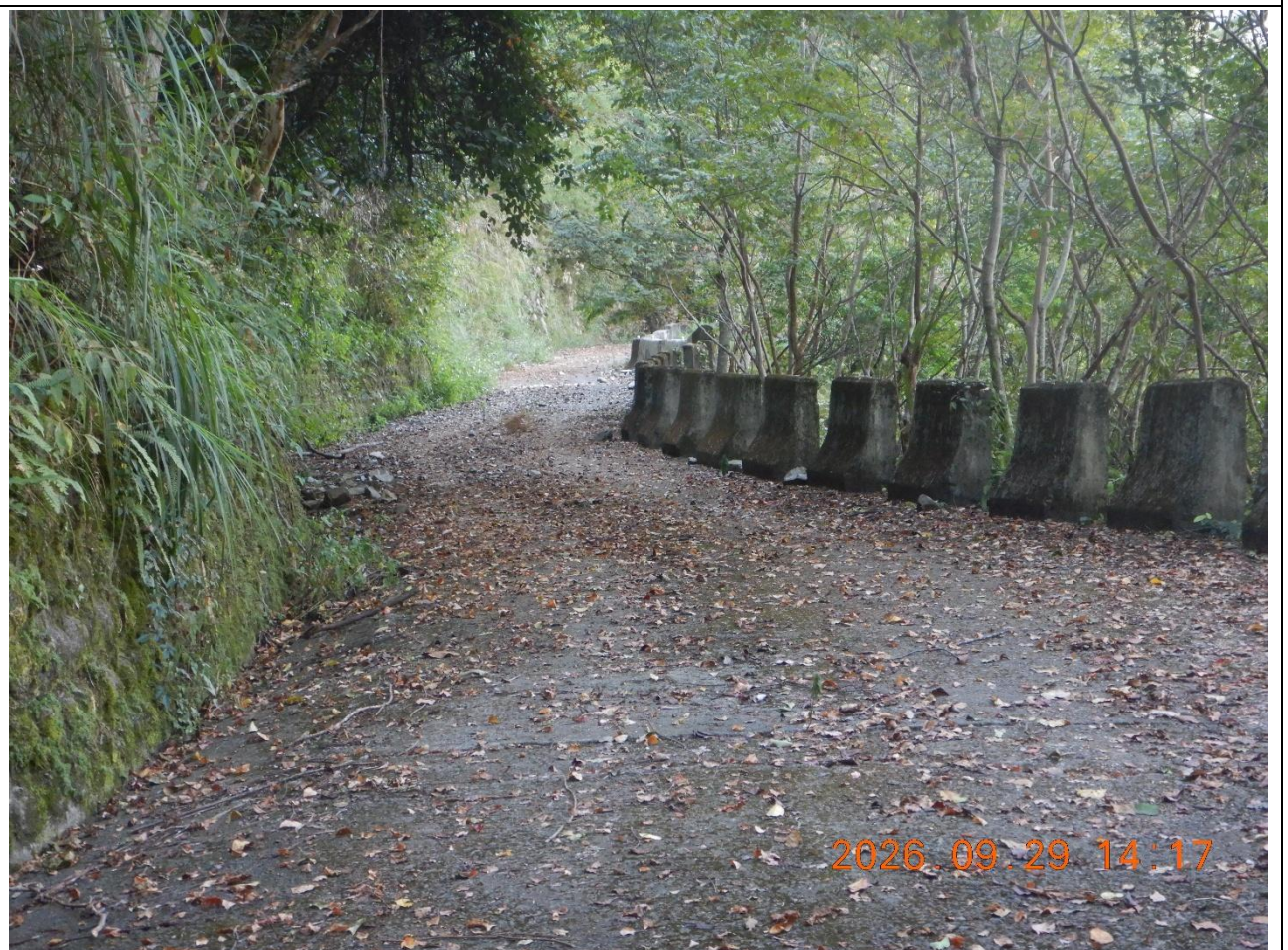
圖片6：0K+550，路面落石及邊溝枯枝落葉堆積，護欄無意狀。
