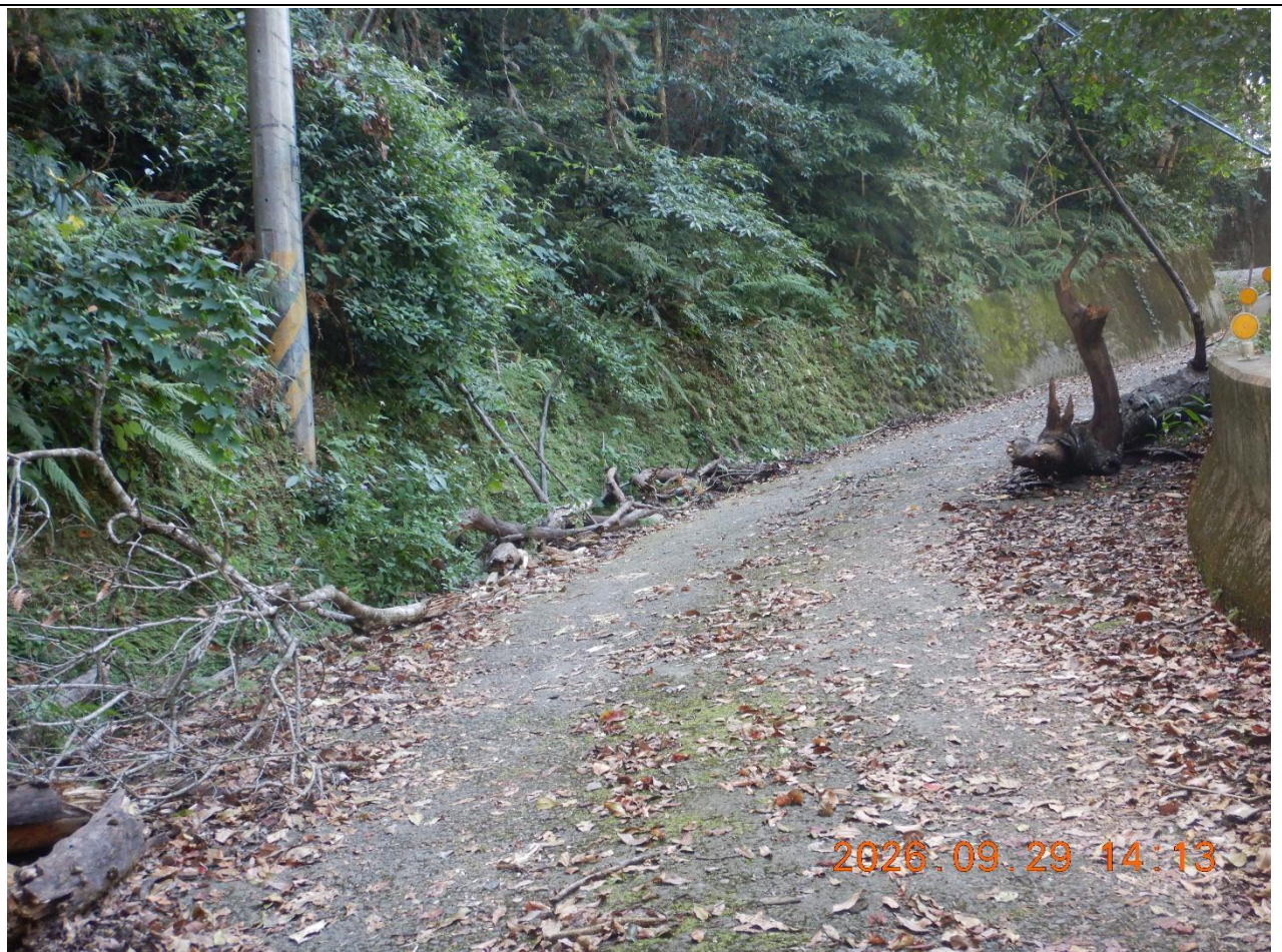
圖片2：0K+270，路面倒木，邊溝堆積，護欄無異狀。
