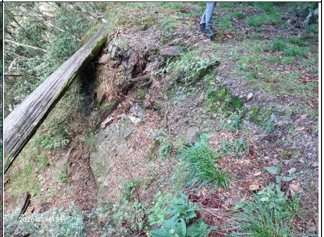
裡冷林道37.8K處，林道靠邊坡的部分有下滑，可行走路面逐漸縮減中，行經該路段要盡量靠內側，車輛行駛較為危險。
