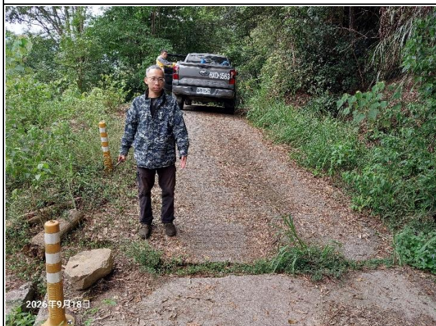
裡冷林道11K+400處，水泥路面有裂開下陷，裂縫變大，傾斜度增加。
