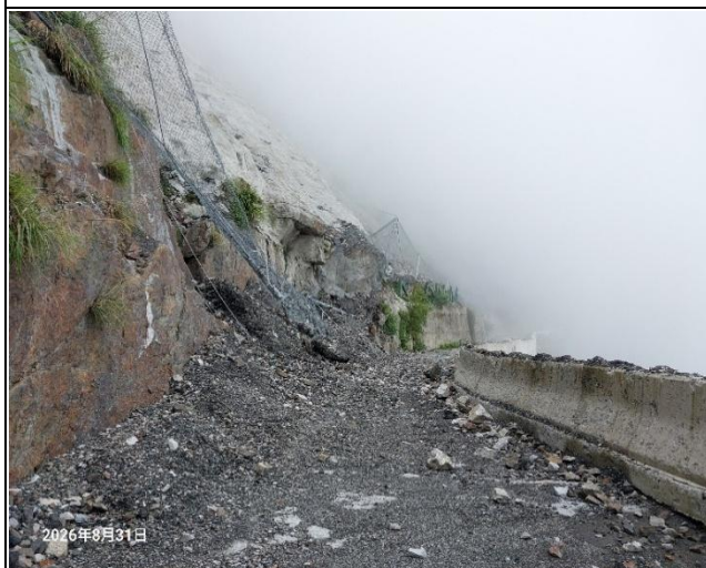
裡冷林道18.4K處，有下雨就還是會持續掉落土石，目前可通行。
