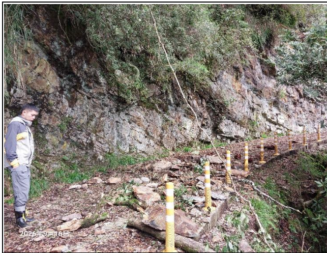
裡冷林道35.5K處，有落石掉落至面，車輛暫時無法通行。
