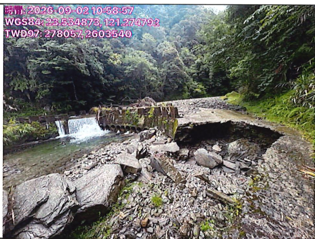
(9)林道19k+000處 水泥路面掏空 座標：X:278057；Y:2603540。
