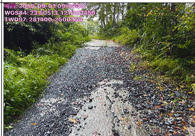
(6)林道4k+200處 路面碎石 座標：X:281400；Y:2600253。
