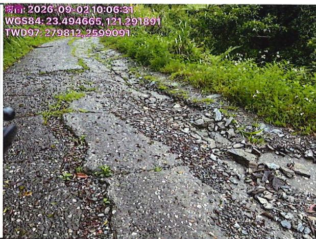
(7)林道9k+600處 水泥路面破碎，右側雨水沖刷 座標：X:279812；Y:2599091。
