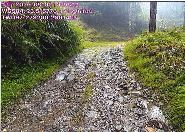
(8)林道16k+400處 路面碎石 座標：X:278200；Y:2601425。
