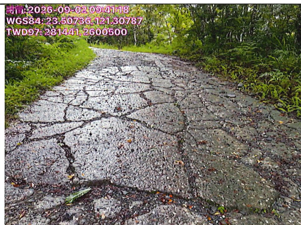
(5)林道3k+200處 路面破碎 座標：X:281441；Y:2600500。
