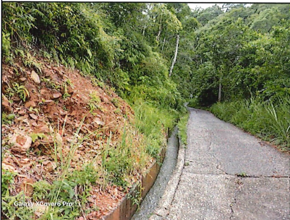
(7)4k+900處 座標X:274421 Y:2573971 小部份土表裸露，順勢沖刷有機會覆蓋排水溝形成淹塞。目前植被逐漸自然演替持續觀察。
