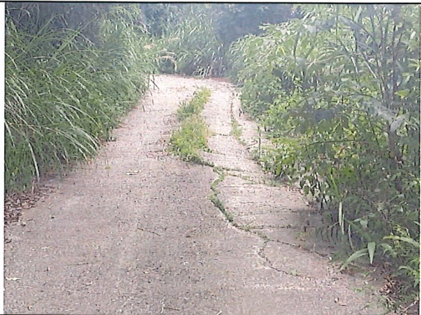
(2)5K+850處 座標X:276785 Y:2573625 林 道路面呈現混凝土劣化碎裂／破損，建議進行平整化修補改善。
