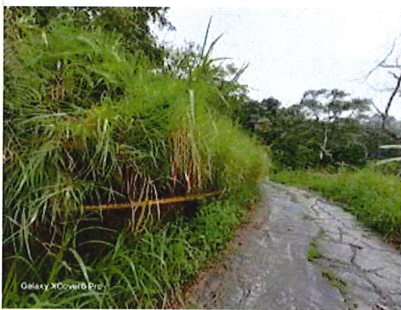
(5)6K+900處 座標X:275918 Y:2573456 擋土牆上方受土石壓力擠壓，結構體已呈現傾斜且牆體受損裂縫龜裂，若不幸倒塌將形成大量土石順勢崩塌，進而阻斷林道交通影響用路人之虞。(巡查員已設警示帶預警)
