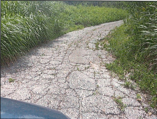
(3)1K+350處 座標X:278710 Y:2575323 林道 路面呈現混凝土劣化碎裂／破損，建議進行平整化修補改善。
