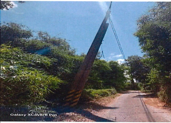
(9)0K+700處 座標X:279059 Y:2575464 台電電桿歪斜為林道方向。
