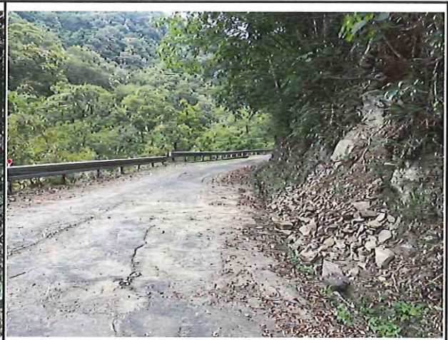
坡面崩塌-10K+700m 現況 (拍攝日期:2026/5/28)
