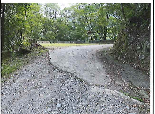
碎石路面-2K+900m 土石流失 落差過大 (拍攝日期:2026/5/28)
