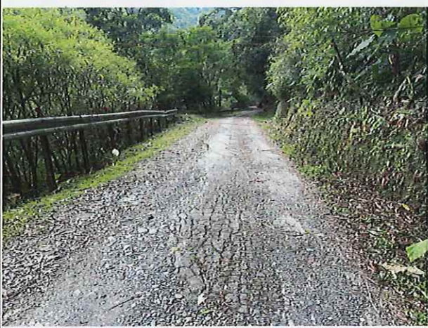
碎石路面-10K+300m 土石流失 左右落差大 (拍攝日期:2026/5/28)
