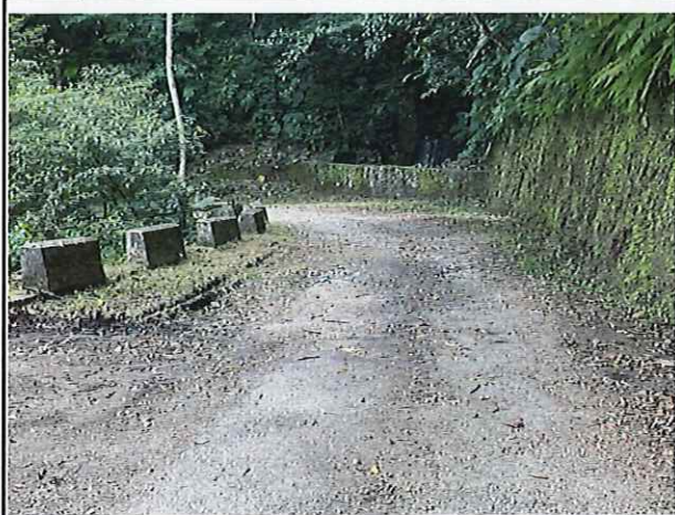
碎石路面-3K+850m 土石流失 (拍攝日期:2026/5/28)
