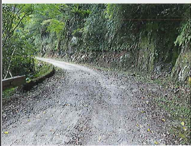
碎石路面-8K+500m 土石流失 (拍攝日期:2026/5/28)
