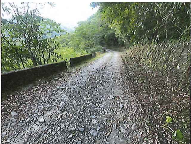
碎石路面-2K+200m 土石流失 (拍攝日期:2026/5/28)
