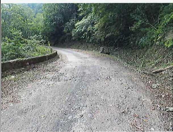
碎石路面-4K+100m 土石流失 (拍攝日期:2026/5/28)
