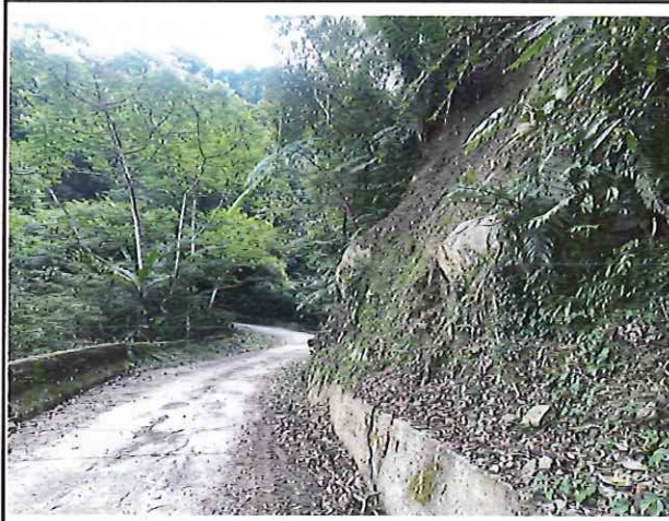
坡面崩塌-2K+100m 現況 (拍攝日期:2026/5/28)
