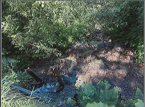
6K 加固完成後土石仍逐漸流失 1150526
