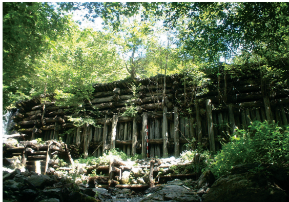
圖8 木堰堤：1983~1991年補修，補強施工堤高：7.0 m， 天端幅(上長)：41.0 m，最大原木直徑：35 cm，最小 原木直徑：25 cm
