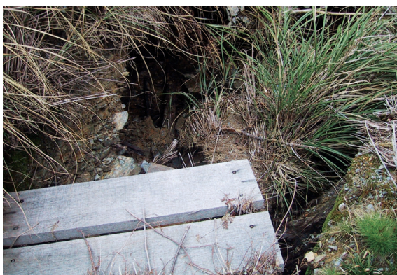
▲暗溝出口因沖刷而崩塌。
