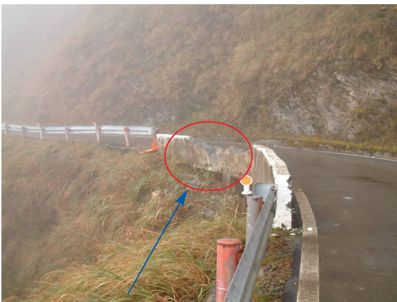
▲照片1 翠峰林道4 km+400 m至5 km路寬2.8~3.5 m部分路段上下邊坡非常陡峻，車輛行駛護欄易遭受撞擊，影響行車安全。
