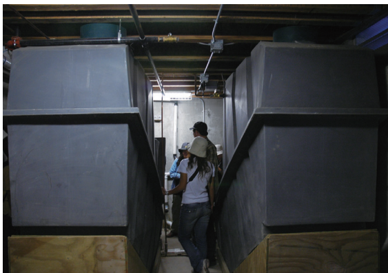
▲照片37 設置於建築物地下室的污水收集槽（圖8之1）。
