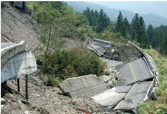
▲照片4 94年海棠颱風宜專一線公路11.5 k路基流失。
