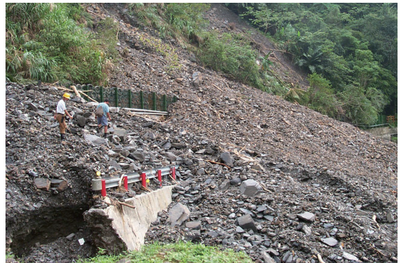
▲照片1 90年納莉颱風邊坡土石崩塌。
