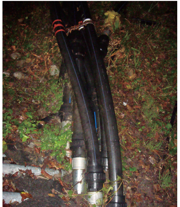
▲瑞岩溪野生動物重要棲息環境之水管路。
