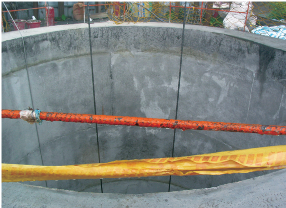
▲照片10 R.C集水井施設。
