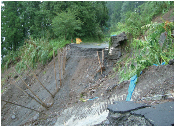
▲照片2 海棠颱風造成宜專一線6K+500m之災害情形。
