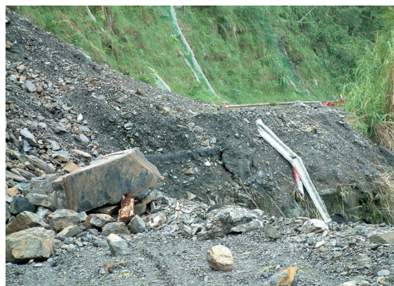
▲照片1 海棠颱風後造成宜專一線6K + 200m之災害情形。
