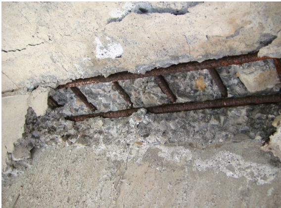
▲照片6 鋼筋銹蝕外露補強施工前。
