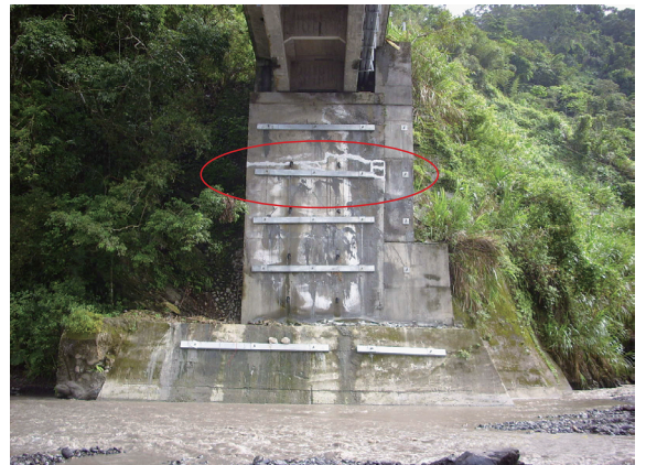
▲照片5 橋台裂縫及岩釘補強竣工。
