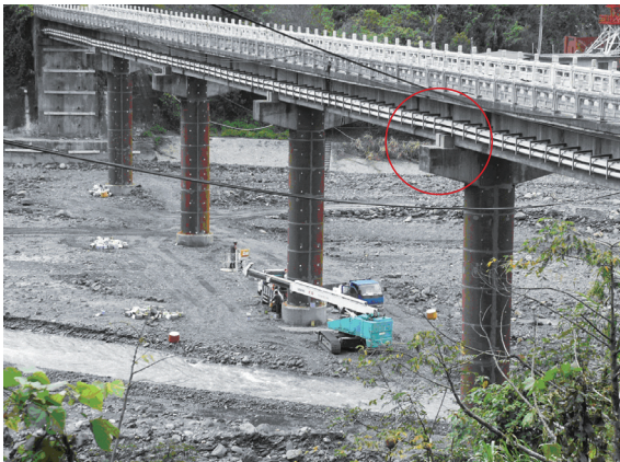
▲照片11 多望橋防止落橋裝置。
