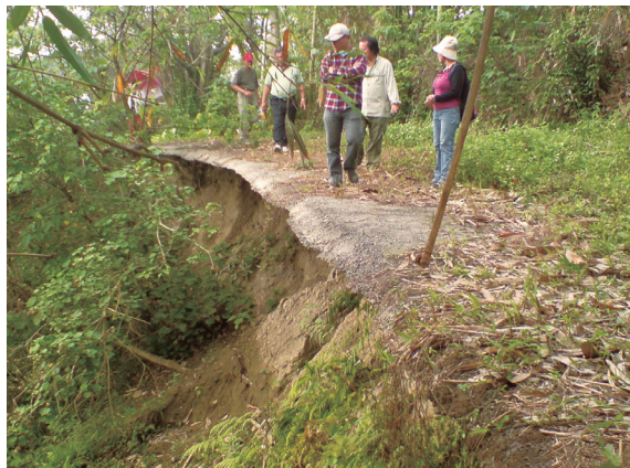
▲照片18 區內農路損壞申請維護現場會勘情形。
