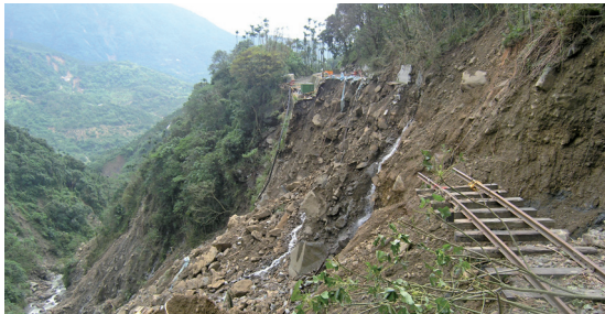
莫拉克風災後路基崩塌擴大照片
