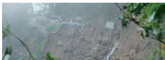
崩塌邊坡莫拉克風災期間滲水照片
