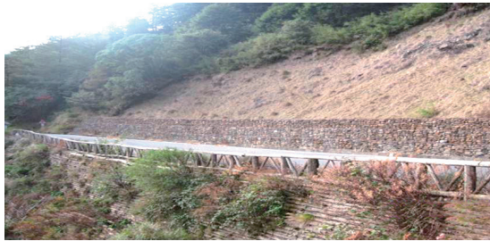
圖13 堆疊式多階木格框擋土牆(94年，大雪山林道47.1K)
