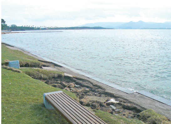
照片1 博多港海岸侵蝕嚴重
