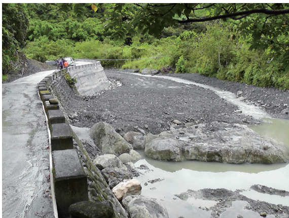
▲東河鄉尚德村七塊厝一號橋下游河道，部份區段遭溪水掏空，臺東林管處於8月初以新建擋土護岸，並完成溪床土石清淤工作。（攝影／臺東林區管理處 林志峰）
