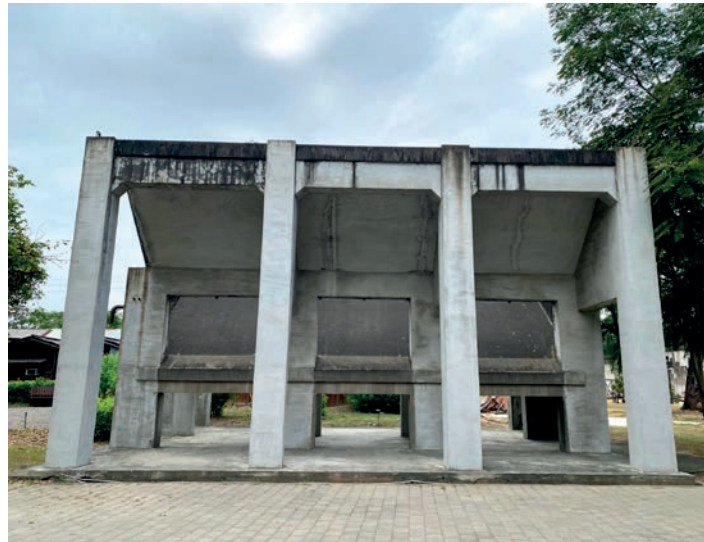
■ 鋸屑室的上方原有木造房以存放木屑角料，今已損壞。
