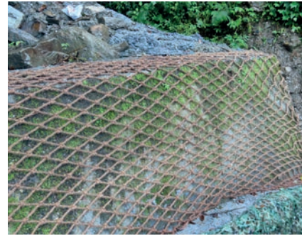
■ 擋土牆上設置棉質攀爬網
