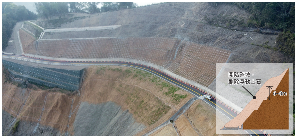
■ 藤枝 18K 周邊路段第一期整治配置（上圖）與 2021 年 5 月工地現況（下圖）
